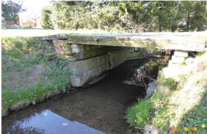
Most čekající na opravu u bytového domu č. p. 261
