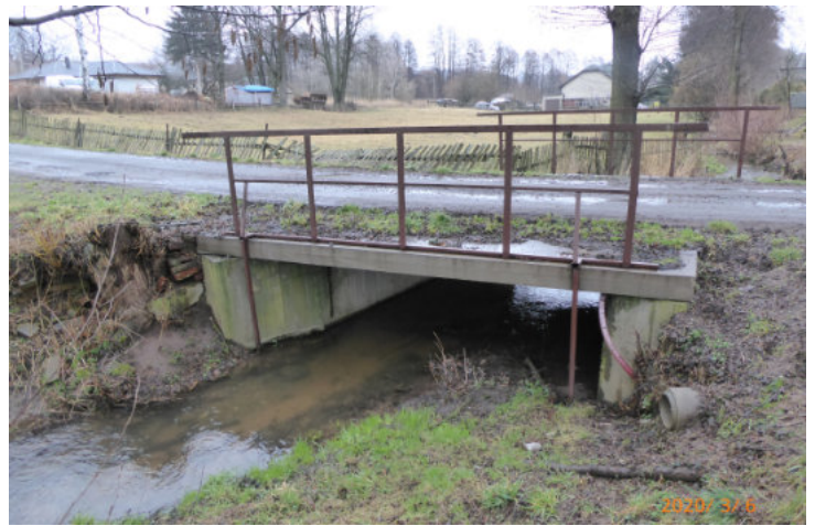
Most čekající na opravu u bytového domu č. p. 262
