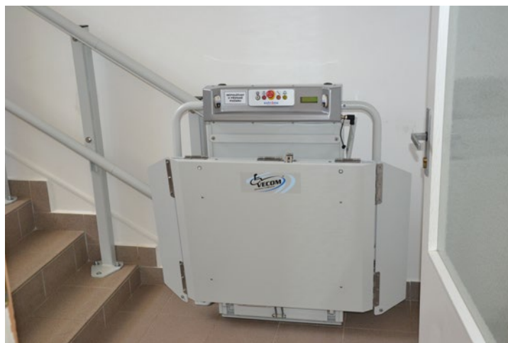
Výtah do podatelny obecního úřadu
